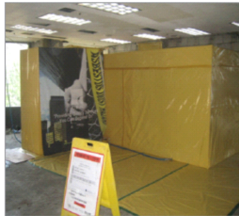
[그림 10-7] 위생설비 측면에 설치한 석면폐기물 반출구 예시
